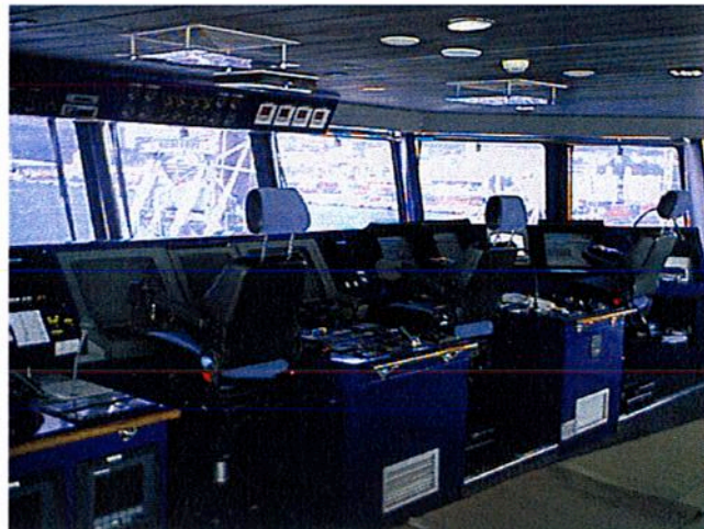
Figure 6 : Les trois pupitres principaux de la passerelle du NGV Liamone . De gauche à droite : veille et conduite (2 pupitres) et technique (1 pupitre).
